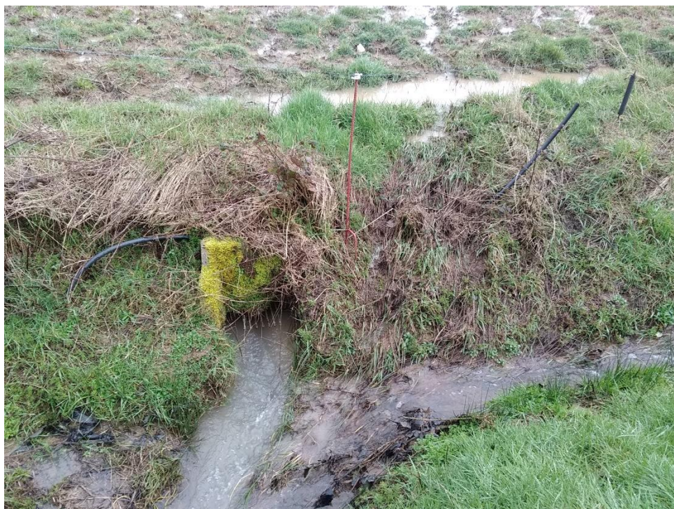
Photo 17 : Fossé circulant véhiculant des eaux de ruissellement et de drainage en provenance de la parcelle attenante et des effluents dilués (rejet non autorisé) en provenance d'un ouvrage de stockage
