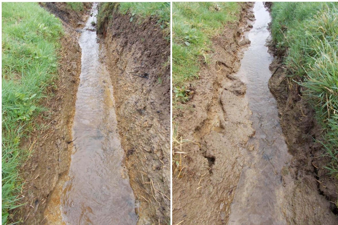
Photo 18 : Fossés circulants curés à blanc sur le BV de la Colmont (février 2020)
