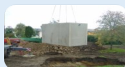
Utilisation des eaux pluviales à COMMER
